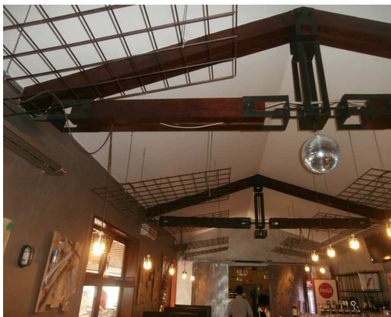
Ft. 5 soffitto locale commerciale ( zona bar)
